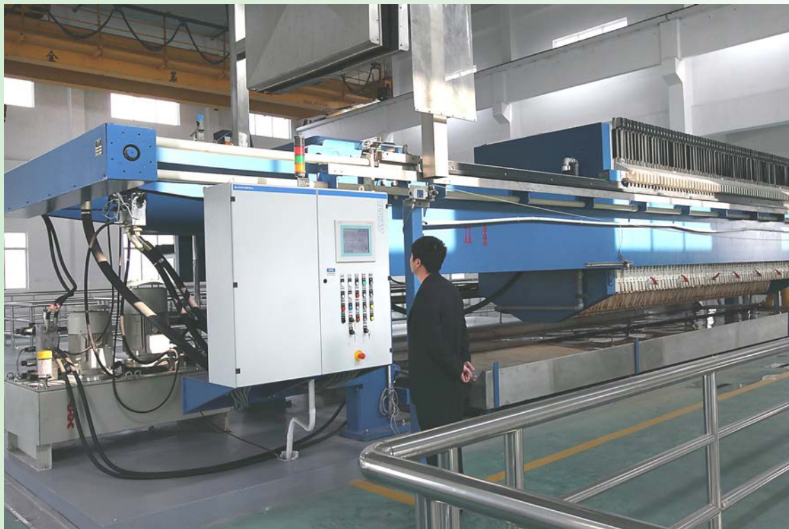
污泥脱水系统设备
